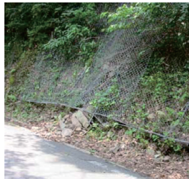
落石防護網裾のこぼれ出し状況
