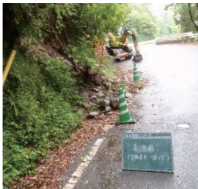
小規模崩壊の状況
