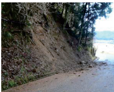
施工前：斜面崩壊
